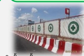
ติดตั้งแผงกั้น (Concrete Barrier) แสดงขอบเขตพื้นที่ก่อสร้าง
